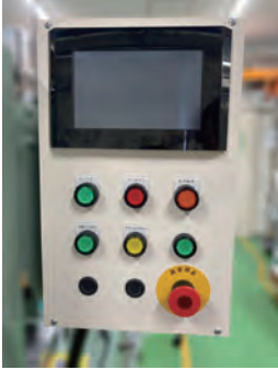
プレス用コントローラ(タッチパネル操作)
